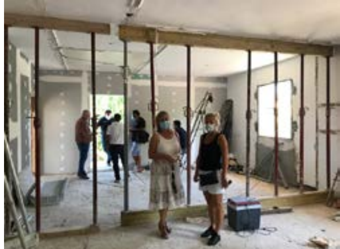
Réunion de chantier en présence Valérie OLLERMOULET, Sandrine IBERTI, Jean-Luc BOULAKIRBA et des entreprises.
